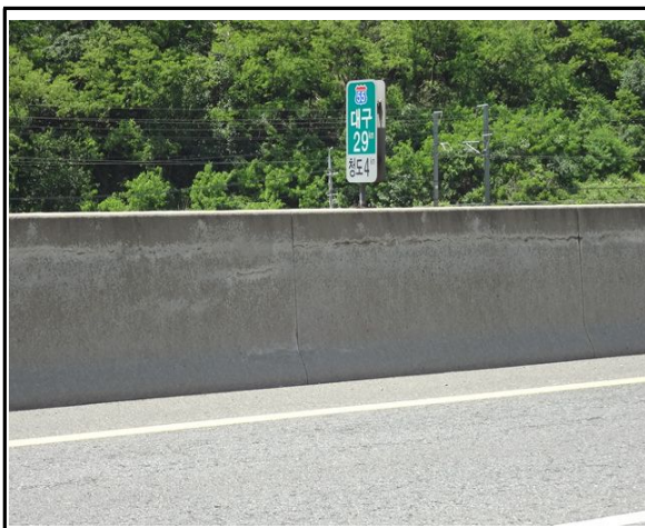
상행선 S4 균열
